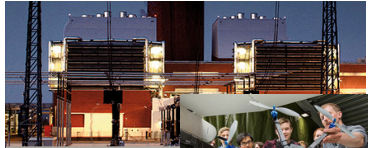
ABB, Akershus Energi
