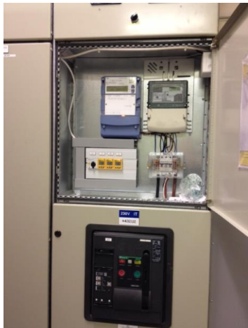
Installasjon på Nordlandssykehuset
