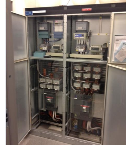
Installasjon på Kila skole
